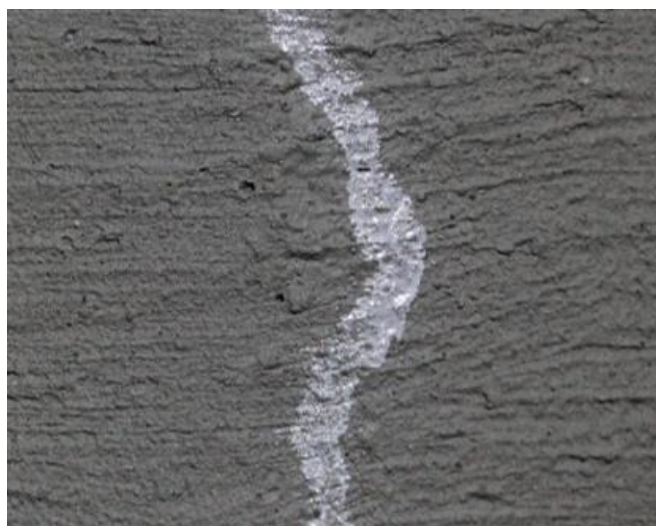
Fot. 5. Pomalý rast kryštálov soli na povrchu trhlín, finálne utesnenie. Účinok po 35 dňoch.
